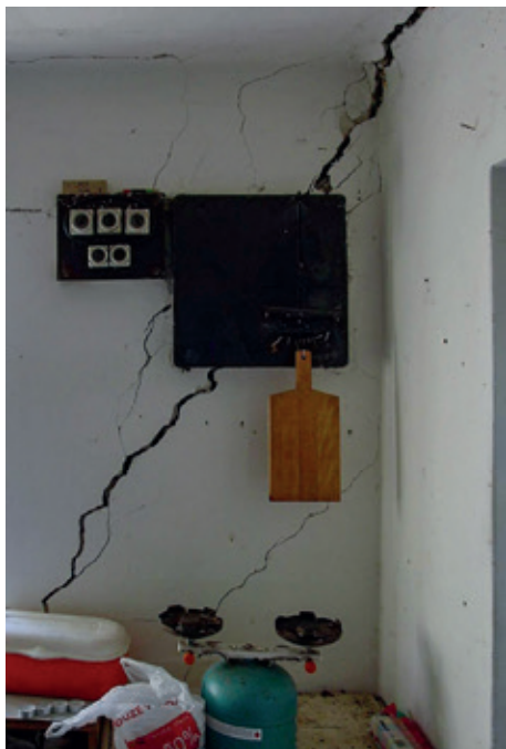
Obr. 8: Dokladem pokračujícího rozkladu váhovny je i trhlina ve stěně kuchyňky. Foto J. Chytil, 20. 9. 2004.
