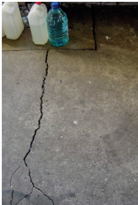
Obr. 10: Důsledkem oprav železničního svršku blízke trati byly i trhliny v betonové podlaze. Foto J. Chytil, 20. 9. 2000.
