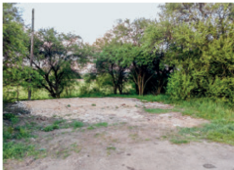
Obr. 24: Po váhovně zbyla pouze základová betonová deska. Foto J. Chytil, 7. 5. 2021.
