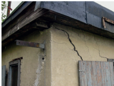
Obr. 9: Neopravitelné trhliny v obvodových stěnách byly dobře patrné i zvenčí. Foto J. Chytil, 4. 10. 2003.
