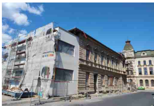
Celkový pohled na rekonstruovaný „Blažkův dům“ v Bratrské ulici. V pozadí nároží Městského domu.
